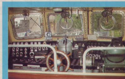
Der Arbeitsplatz des Schiffsführers im Steuerhaus: (v.l.) 380- und 24-Volt-Schaltanlage, Echolot, Magnetkompaß, Ruderanlage mit Anzeiger, Getriebe-steuerung, Radar.
